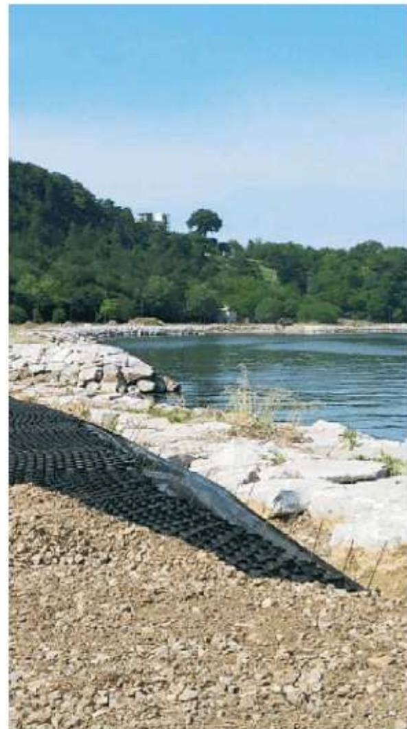
Il cantiere di Acquario sulla riviera muggesana in una foto di alcuni mesi fa
